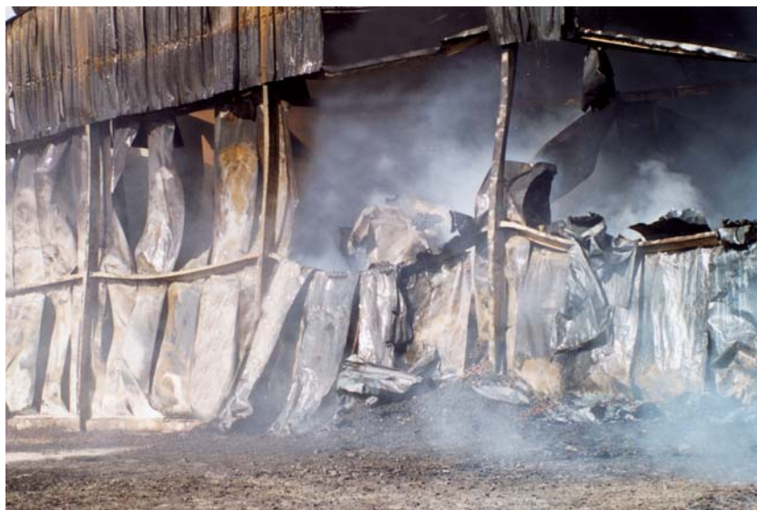
Fig. 11 É frequente a torção de elementos metálicos, quando sujeitos a um incêndio.
