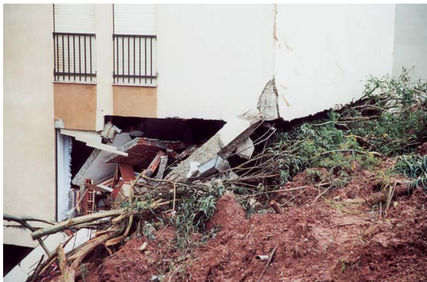
Fig. 21 Construções instáveis devido ao deslizamento de terras.
