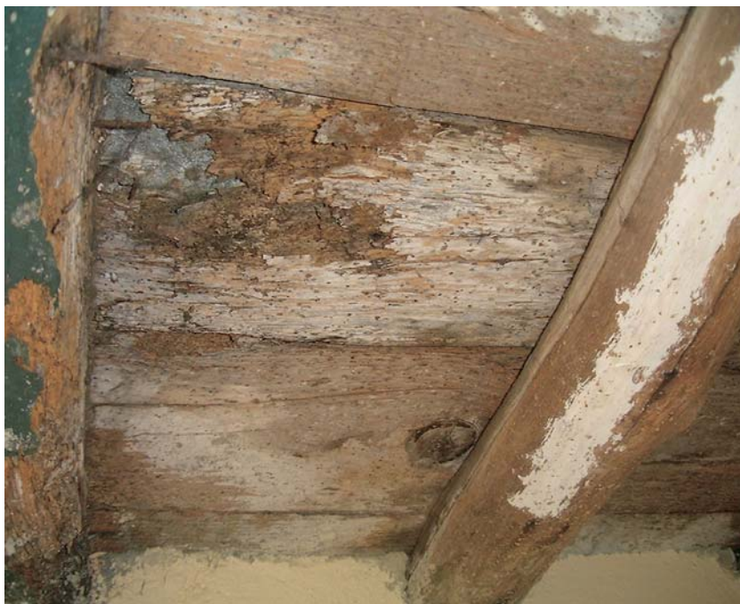
Fig. 43 Pavimento afectado pela água.
