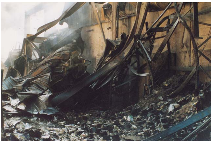
Fig. 41 Construção metálica afectada por um incêndio.
