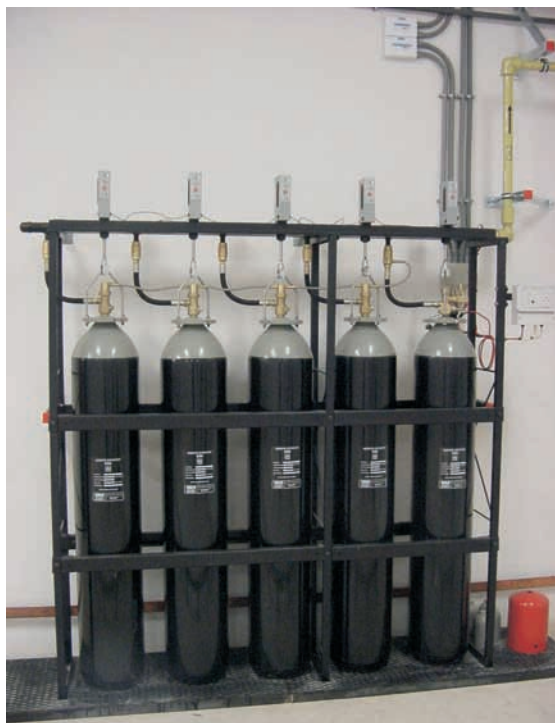
Fig. 29 Instalação fixa de CO 2 .
