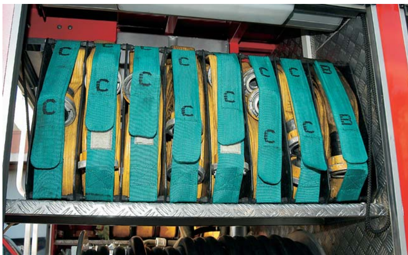
Fig. 2 Vista geral do cofre de mangueiras de um veículo urbano de combate a incêndios.
