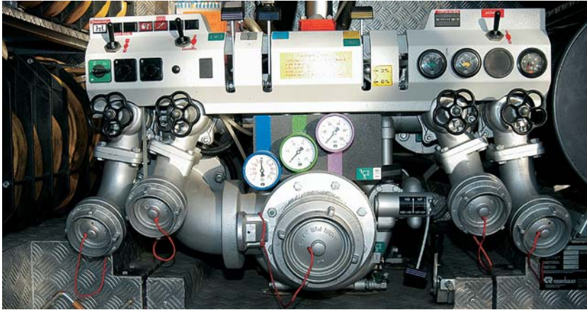
Fig. 79 Bomba de incêndio de um veículo urbano de combate a incêndios.
